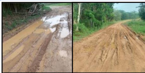
Gambar 16. Lokasi Jalan Rusak di Terminal Santan
